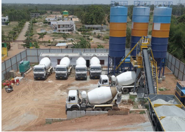
RMC Plant(03 NOS)
